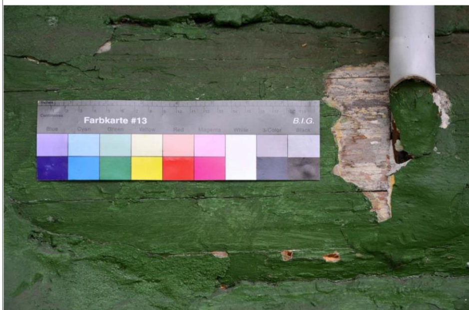
Obr. 05 Poškozené místo nátěru roubení východního průčelí domu č. p. 81, s patrnými fragmenty starších nátěrů. Foto J. Koudelová, 2014.
