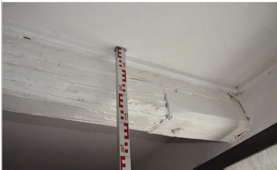
Obr. 04 Část měněného konce stropnice v menší světnici domu č. p. 81. Foto J. Koudelová, 2014.
