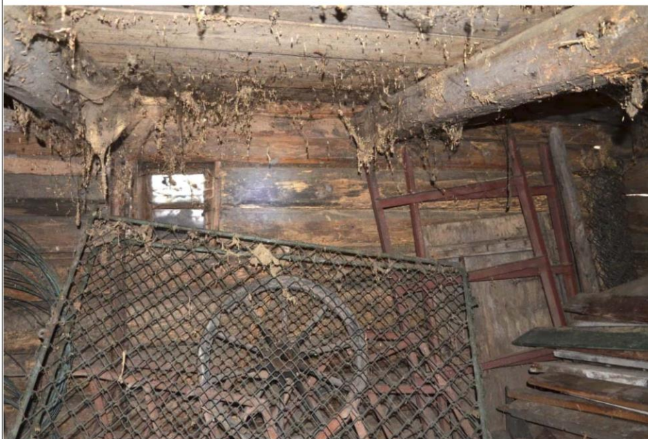
Obr. 04 Vnitřní západní roubená stěna komory stodoly u č. p. 1003. Foto O. Schejbal, 2013.
